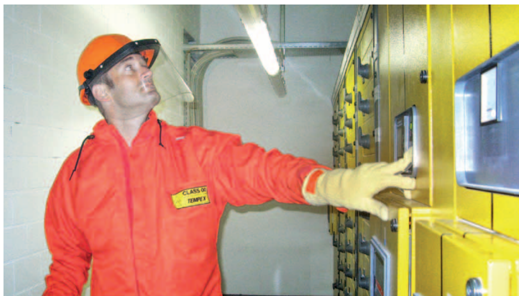
Der Stromausfall wird geprobt: Im Schutzanzug schaltet der Elektriker Silvio Veronesi den Strom zurück auf Normalspannung. (Bild Florian Meyer/ETH Zürich)
